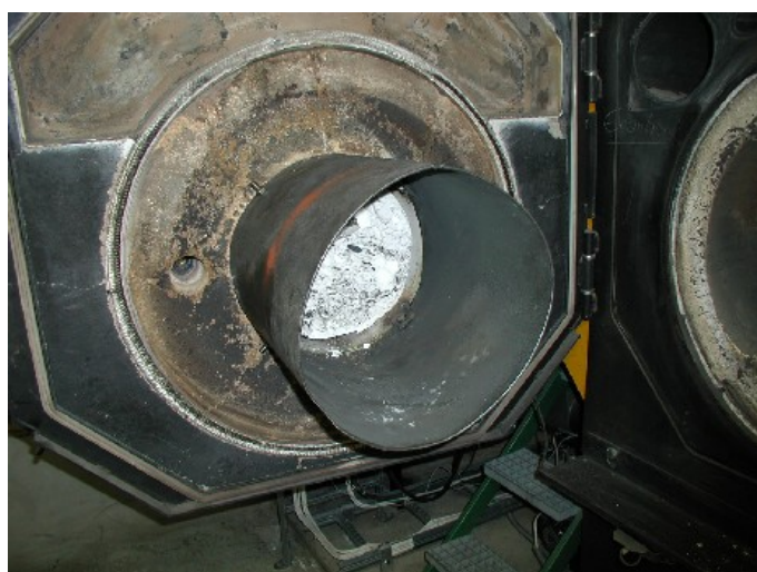
Turbulensrør i et pelletsfyrte anlegg.
