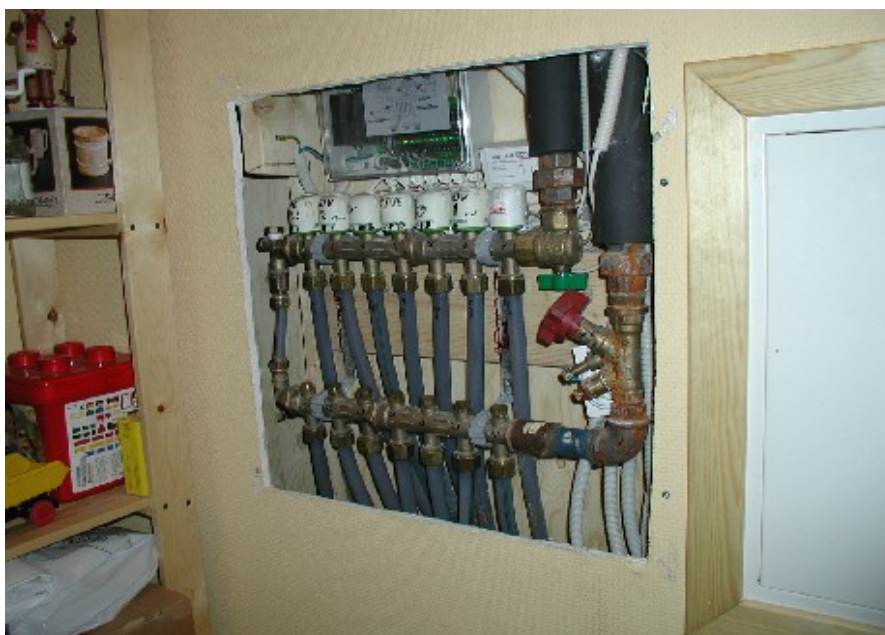
Fordelingsstokker og regulatorer for liten og leilighet - innregulert etter rørlengder.
