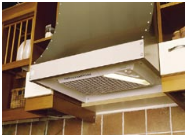
Kjøkkenhetter med eksterne avtrekksvifter
