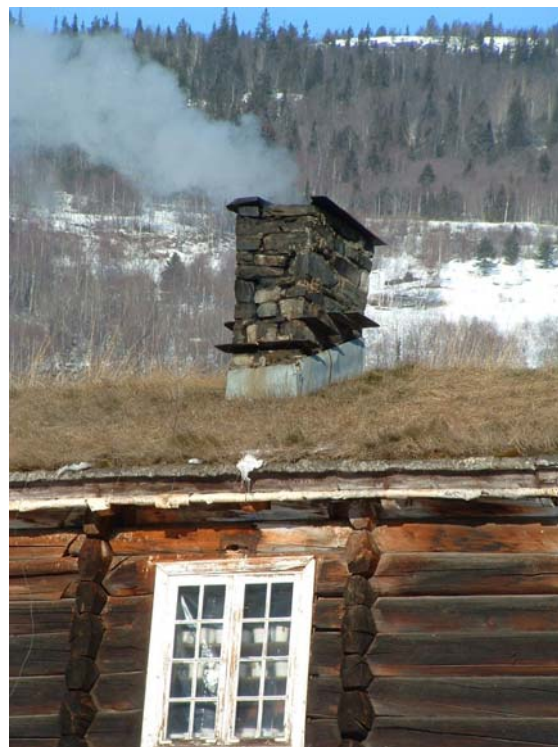
Gamle skorsteiner som ikke er vedlikeholdt kan være i dårlig stand. Her sees ei pipe med skader over tak. Løs og manglende mørtel, løs og forskjøvet stein.
