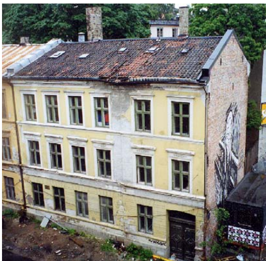
Murgård i dårlig forfatning. Skadene på taket har ført til lekkasjer med påfølgende hussoppangrep, skader i takustikk. Når slike skader får utvikle seg blir istandsettingen kostbar.
